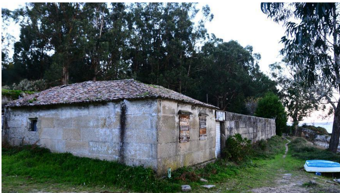
La salazón de Mourisca, en Bueu. Su estado antes de la restauración
