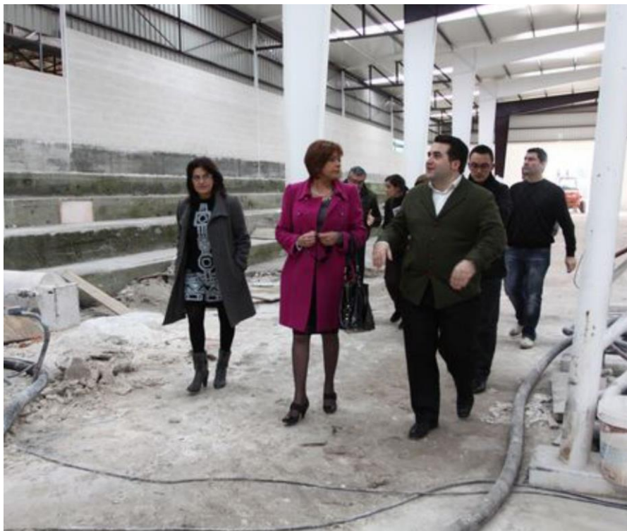
Goberno de 2010 (Clara Millán, xunto a Héctor Otero e Toñi Queimaño) na visita ás obras do novo pavillón. G.N.
